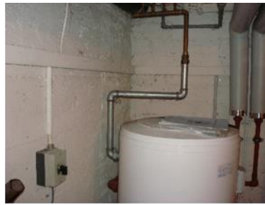
Altbau: Ölkessel mit Boiler. Einsparung durch Weglassen Dämmung CHF 200.00 Mehrverbrauch in 25 Jahren CHF 700.00
