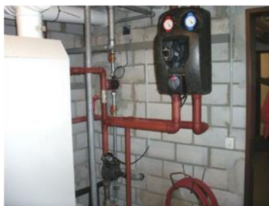
Neubau: Erdgastherme mit Boiler. Einsparung durch Weglassen Dämmung CHF 300.00 Mehrverbrauch in 25 Jahren CHF 600.00
